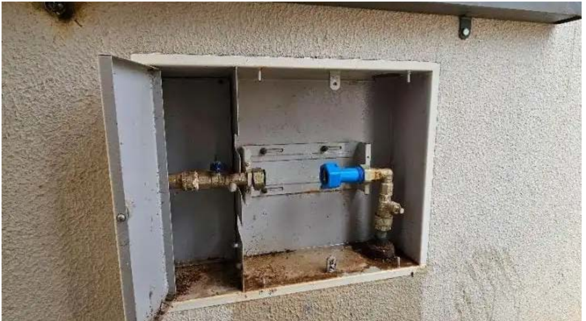
Cavalete após furto de hidrômetros em Franca: Sabesp orienta clientes a como proceder nestes casos (©Divulgação/Sabesp)
