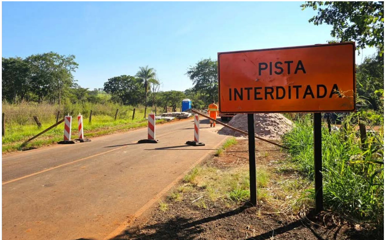
Trecho interditado entre os municípios de Nuporanga e São José da Bela Vista, local onde se encontra a galeria sobre o Ribeirão dos Buritis (©Divulgação)
