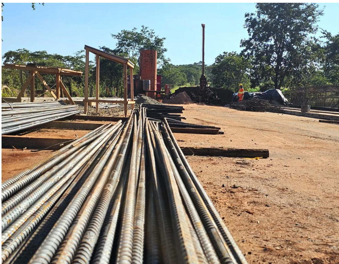
Trecho interditado entre os municípios de Nuporanga e São José da Bela Vista, local onde se encontra a galeria sobre o Ribeirão dos Buritis (©Divulgação)
