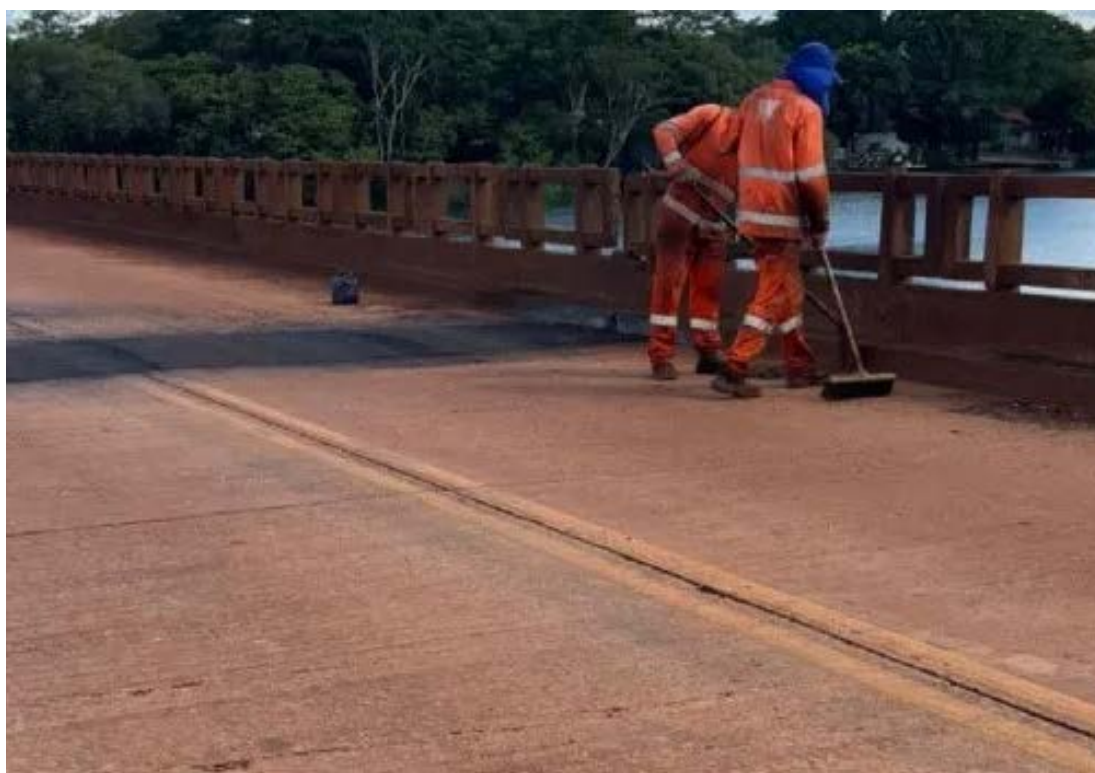
Intervenções garantem segurança da estrutura enquanto estados avançam em busca de solução definitiva (©DER-MG/Divulgação)
