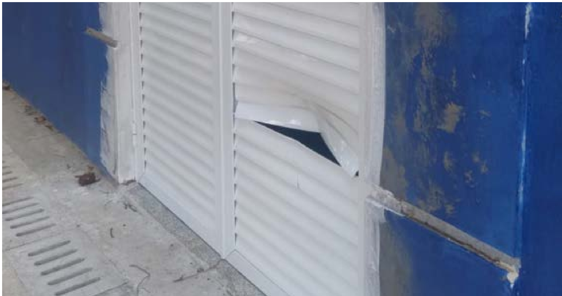
Vandalismo atinge obra da nova farmácia da UBS do Altino Arantes (©Divulgação)
